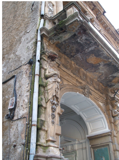
Clădiri cu ornamente care se desprind și cad în stradă
